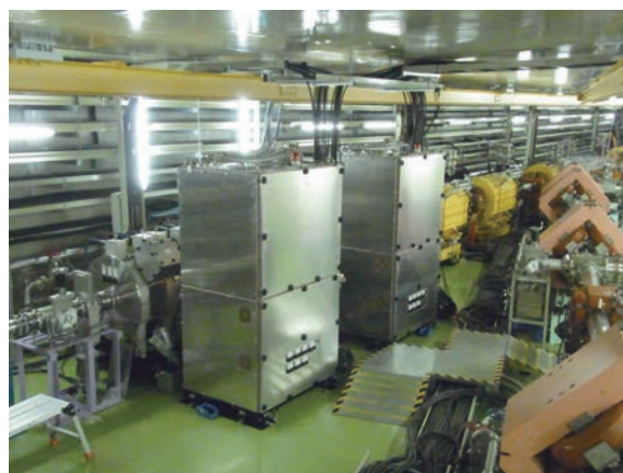
図 3：直線部 A に設置した 2 台の高周波空洞と終段増幅器
