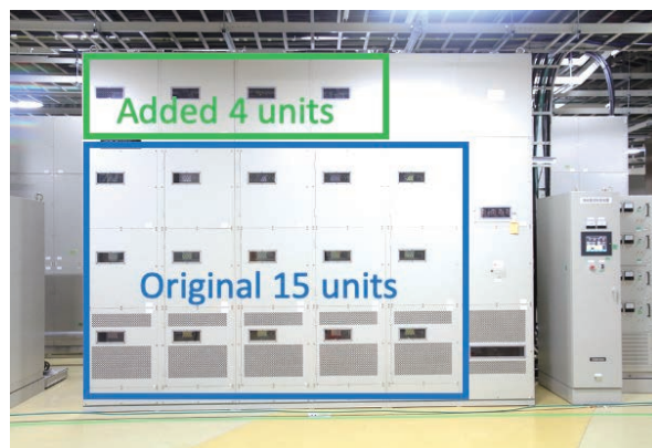
図 10: RCS の RF 陽極電源の写真。元の 15 ユニットのの上に 4 ユニートを設置して増強した。MR も同様の増強を計画している。
